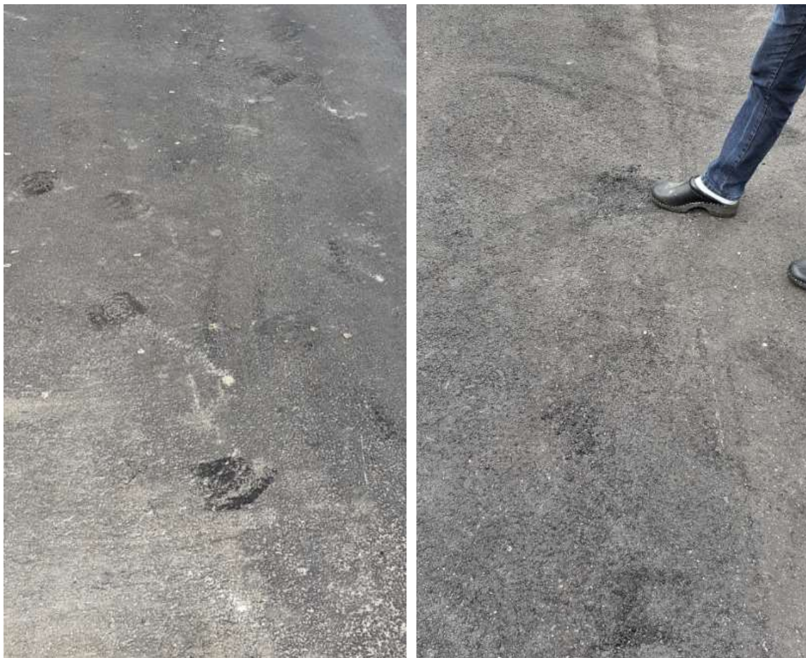
Foto 3.2.3: Eksempler på Fysiske skader på belægning, påført efterfølgende.
