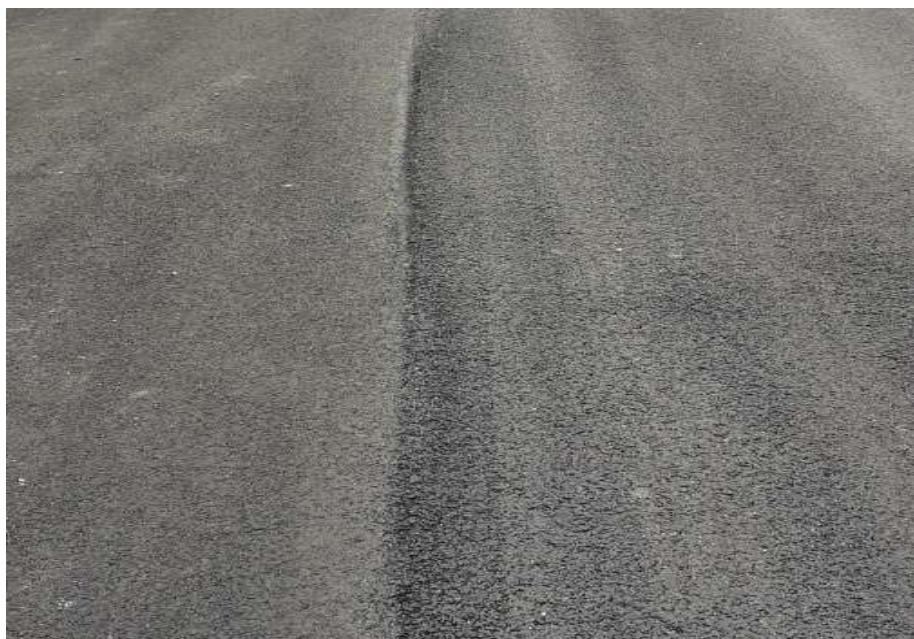
Foto 3.2.1: Dårlig udført samling (Skjoldborg Allé)
