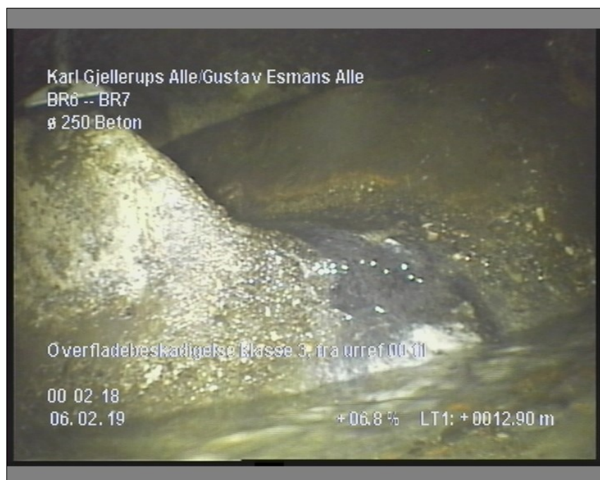
Foto: 7_9A, Medie #: LY19.9007, 00:02:18 12,9m, Overfladebeskadigelse klasse 3, fra urref 00 til urref 12, Stop
