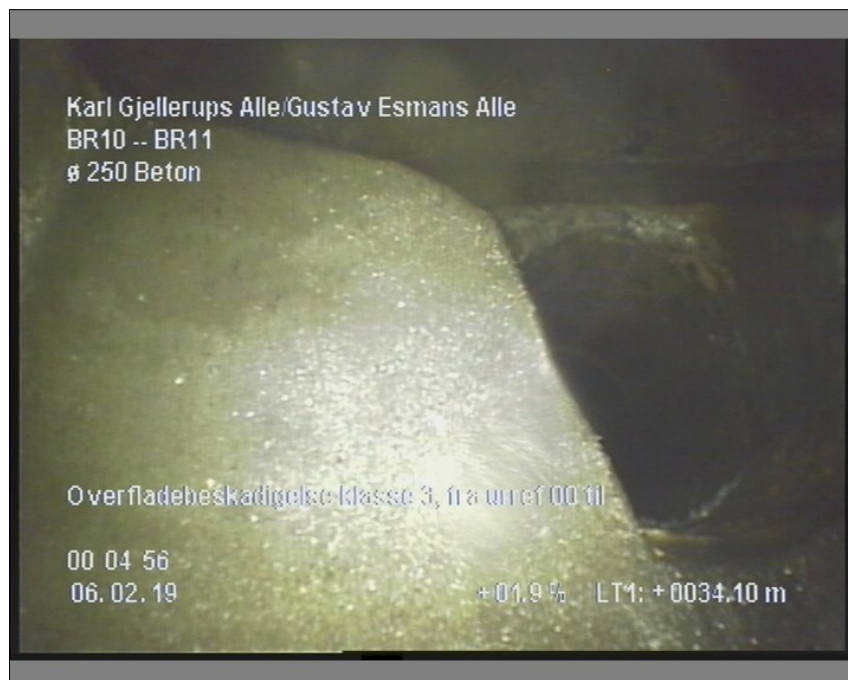
Foto: 10_13A, Medie #: LY19.9007, 00:04:57 34,1m, Overfladebeskadigelse klasse 3, fra urref 00 til urref 12, Stop
